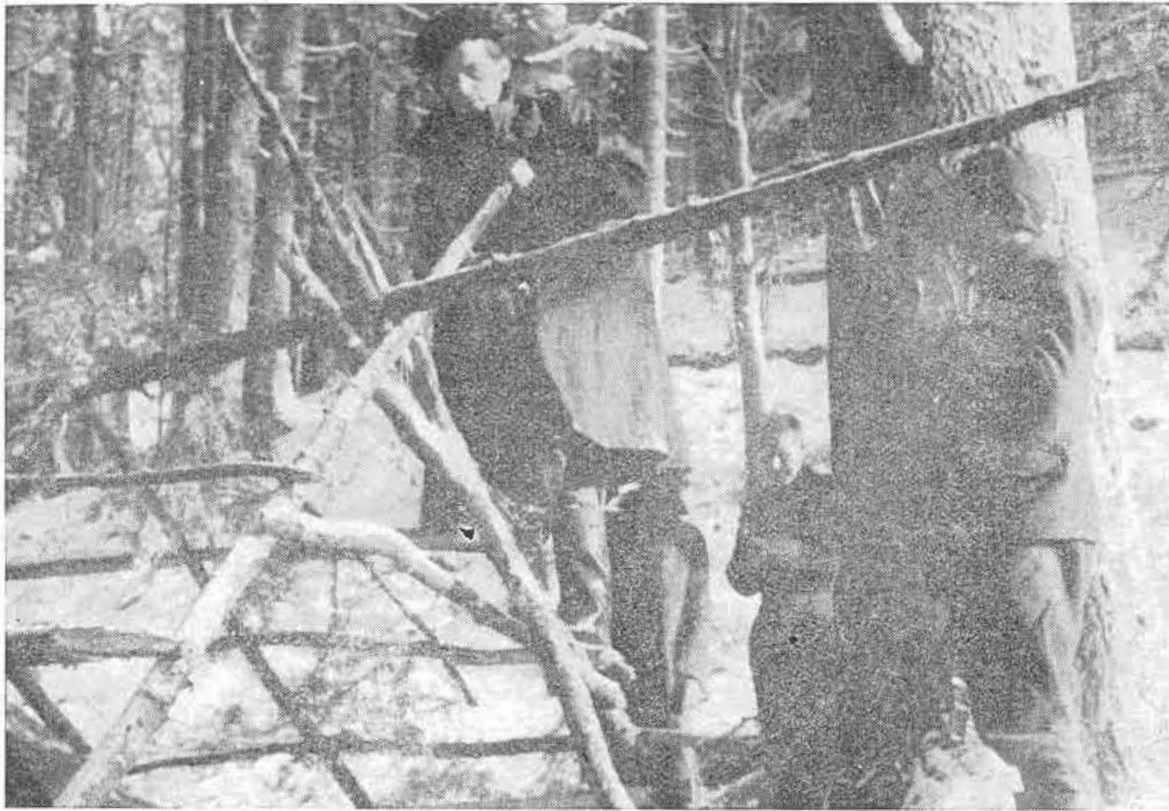
Obr. 13. Stavanie partizánskej koliby pod Jeleňou skalou, Staré Hory. Fotoarchív Múzea SNP, sign. 8022.
